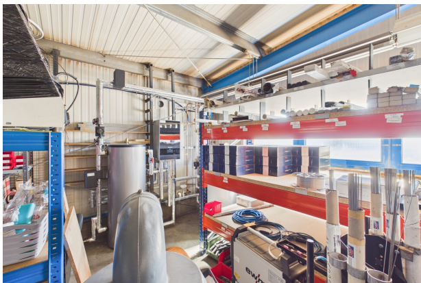
Lager und Heizungsraum
